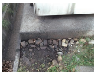
Before 室外機からの油漏れによる土壌汚染
