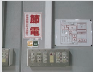
節電 作業時間外は消灯
