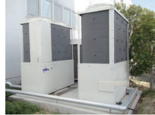
高効率GHPエアコン 2018年改修
