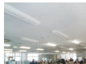
人がいない箇所はキャノピーイッチで蛍光灯を消す
