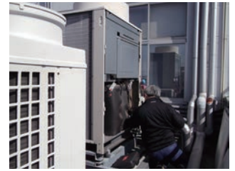
有資格者による定期点検実施
