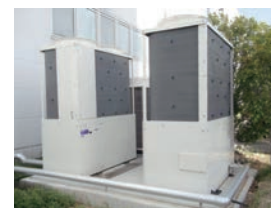
高効率ガスヒートポンプエアコン 2018年1月導入
