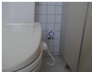
温水・暖房便座の温め時間をタイマー式コンセントにして節電しています
