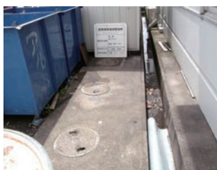
Before 廃液地下タンク
