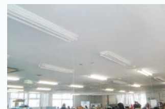
人がいない箇所はキャノピースイッチで 蛍光灯を消している
