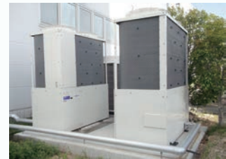
高効率ガスヒートポンプエアコン 2018年1月導入
