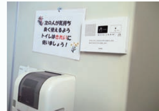
女子トイレには擬音装置を取り付け
