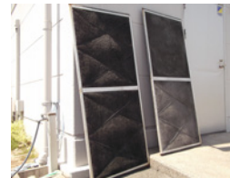
空調機フィルター清掃
