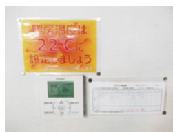
空調設定温度の啓発表示 エアコンフィルター清掃表
